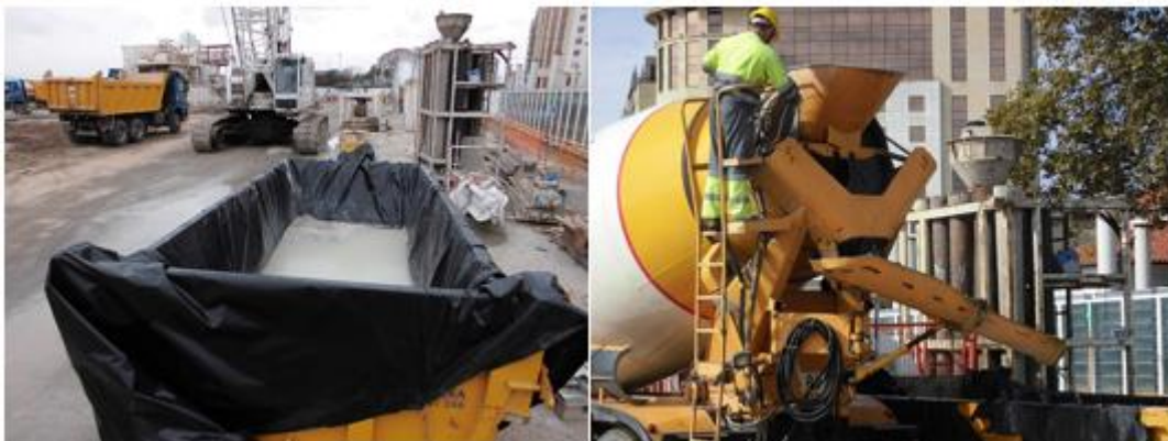
Figura 1. Ejemplo de cuba estanca para el lavado de hormigoneras.
