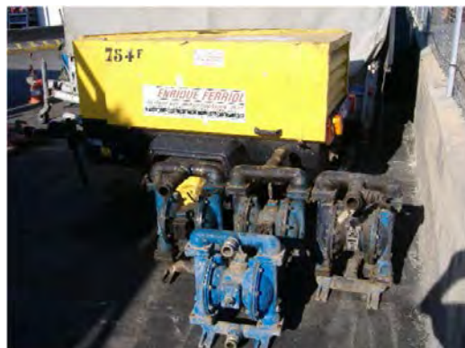
4 bombas neumáticas de 5 m 3 /h, accionadas mediante compresor.
