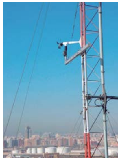
3. Estación Meteorológica Silo
