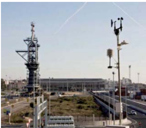
Estación Meteorológica Oficinas Sagunto
