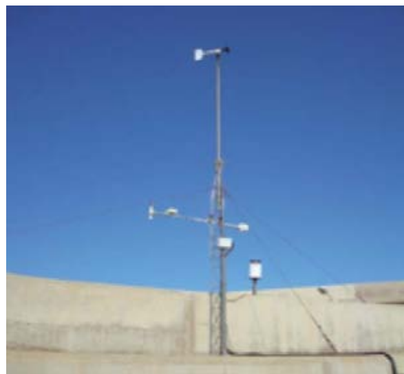
Estación Meteorológica Dique Este Sagunto
