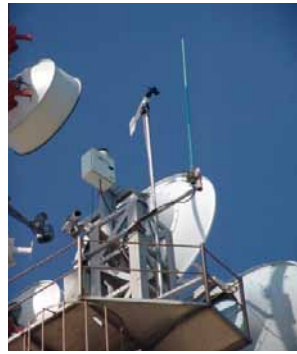
Estación Meteorológica Dique Este Sagunto
