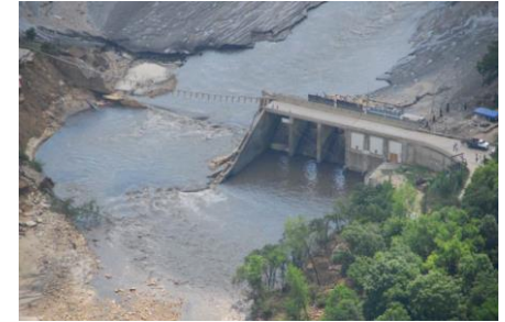
Inundaciones (Rotura presa embalse Loriguilla)
