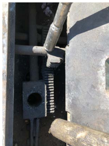
Se aprecia el agujero, en el que se encaja el bulón.
