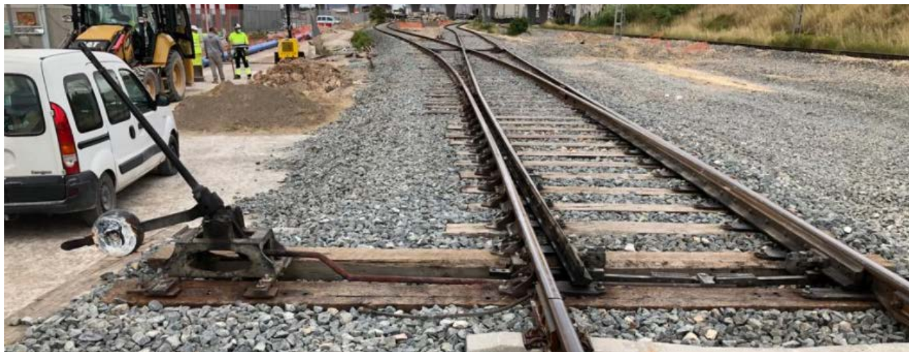
Ejemplo. Imagen del aparato de vía nº 11 visto desde Valencia Puerto Norte: accionado a vía nº 3 (desviada).
