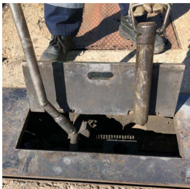
Se aprecia la barra enhebrada al pitón de la cremallera, y el bulón extraído.
