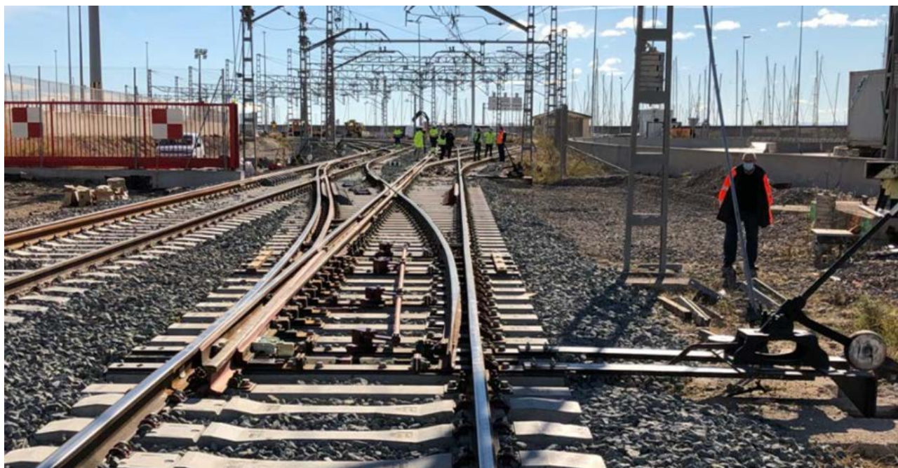
Ejemplo sobre balasto. Imagen de desvío nº 6, visto con dirección a Terminal Muelle Príncipe Felipe (Valencia Puerto Sur). Marmita accionada a vía directa (vía 5).
