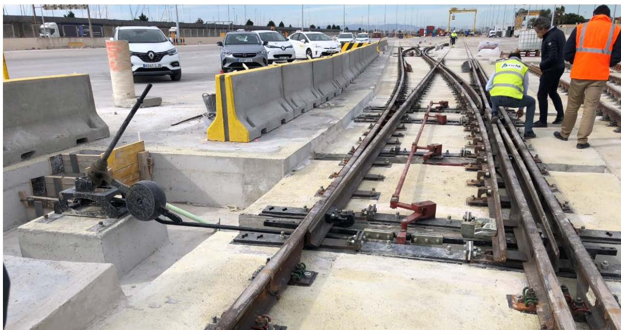
Ejemplo placa hormigón. Imagen de desvío nº 58, visto desde vía mango 103. Marmita accionada a vía directa (vía 103).
