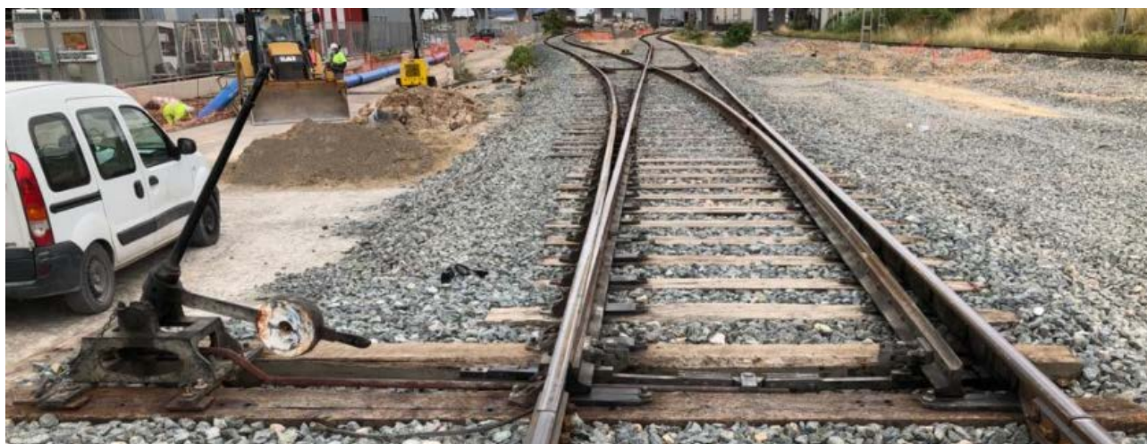
Ejemplo. Imagen del aparato de vía nº 11 visto desde Valencia Puerto Norte: accionado a vía nº 1 (directa).
